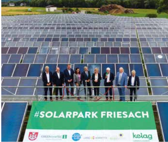
Österreichs größte Solarthermie-Anlage in Friesach.
