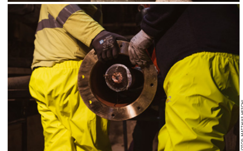
Nach der Kühlung auf -196 Grad: Die stromführenden Litzen müssen einzeln verbunden und mit Isolierschicht aufgebaut werden. Die Muffe wurde speziell für die Reparatur in Wien entwickelt.
